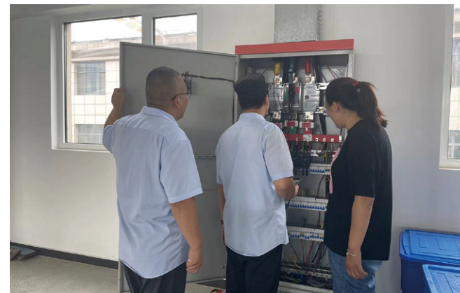
安全生产检查 - 生产设备
