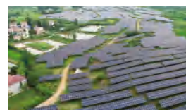
襄阳市尹集乡木桥村 100MW农光互补
