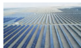
90MW格尔木领跑者项目
